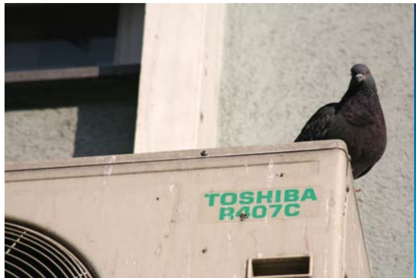
Verkotung von Klimaanlage
